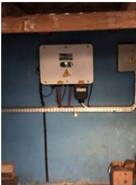
95 - SISTEMA DE ENERGIA SOLAR DO MERCADO
